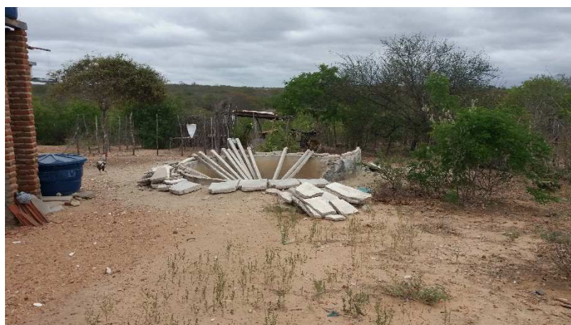
Figura 3. Cisterna sem cobertura e totalmente danificada
