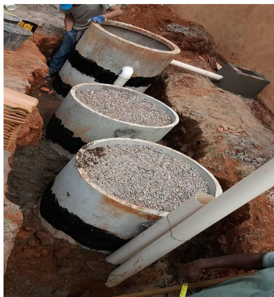
Figura 4. Sistema de tratamento de esgoto.
