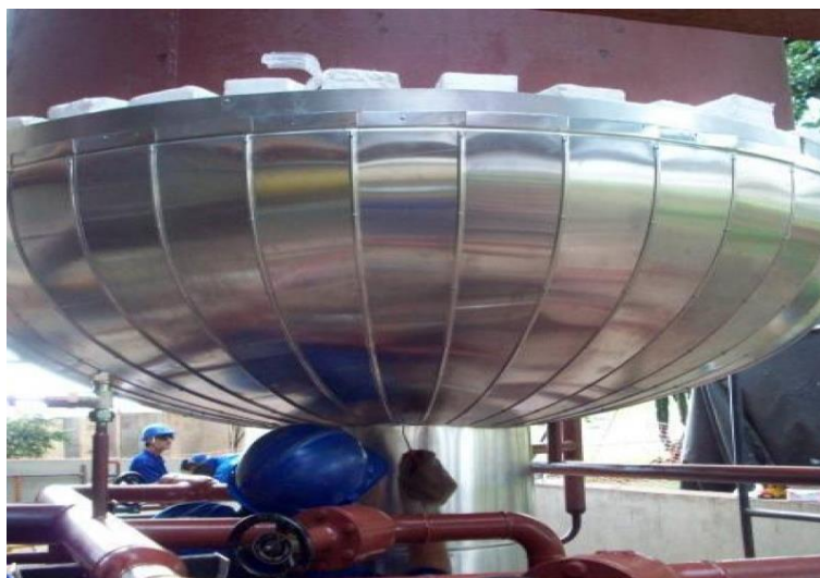
Figura 1. Peça de Funilaria (Cabeça Abaulada) para isolamento térmico de equipamento. Fonte: encurtador.com.br/sAJ67
