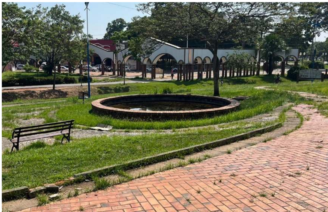
Figura 7. Fonte desativada, meio-fio quebrado, calçada deteriorada.
