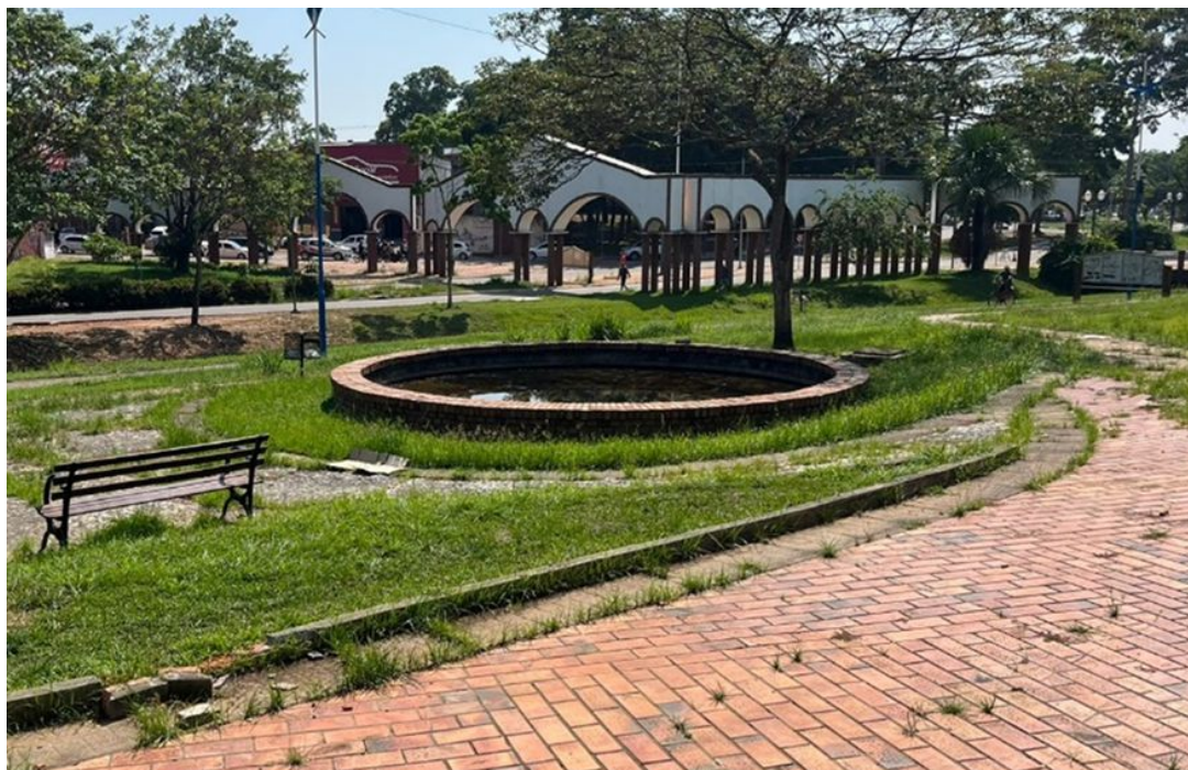
Figura 7. Fonte desativada, meio-fio quebrado, calçada deteriorada.
