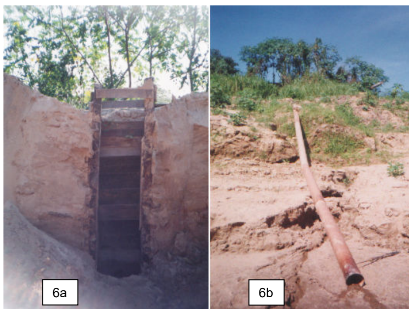
Figura 6. Drenos de retorno da água ao leito do rio. Caixa de drenagem (figura 6a) e tubos de drenagem de PVC de 100 mm de retorno das águas para o rio (figura 6b).
