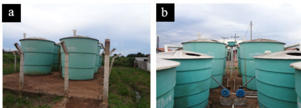
Figura 12. ETE Compacta do Vale do Carandá em Rio Branco, Acre. Sistema que utiliza tratamento biológico: RAFA + Filtro Biológico + Decantador secundário, através de unidades construídas em poliéster reforçado com fibra de vidro.
