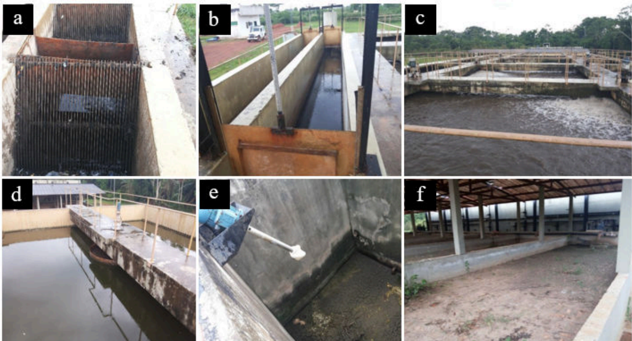
Figura 6. Etapas de funcionamento da ETE Conquista em Rio Branco, Acre. (a) Gradeamento; (b) Caixa de areia; (c) Tanque de aeração; (d) Decantador; (e) Digestor de lodo e (f) Leito de secagem.
